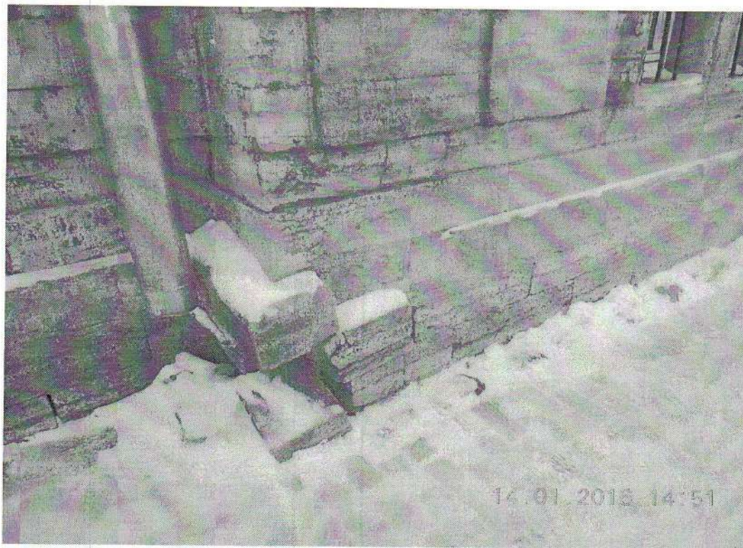
Фото 4. Разрушение северо – восточного угла цоколя западной боковой части северного фасада.
