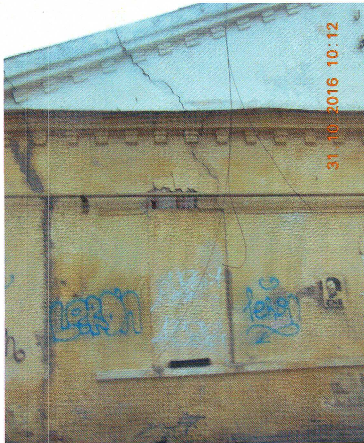
Фото 4. Фрагмент северо – восточного фасада (косые трещины верхних частей основного объема и фронтона). Вид с северо – востока.
