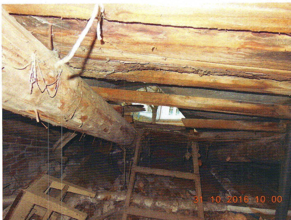
Фото 6. Фрагмент стропильной системы (разрушение, гниение, намокание элементов крыши). Вид на северо – запад.
